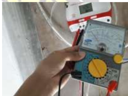
Gambar 7 Pengukuran tegangan dan arus
