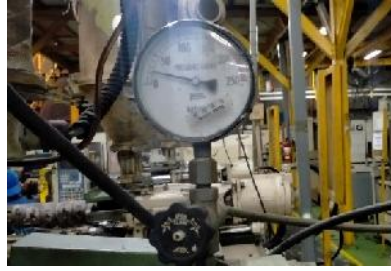
Gambar 3.6 Manometer di Mesin Injection Moulding
